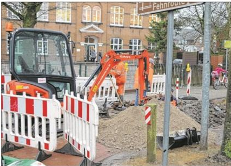
Vor der Daalerschule kam es zum Rohrbruch. BILD: HOFFMANN
